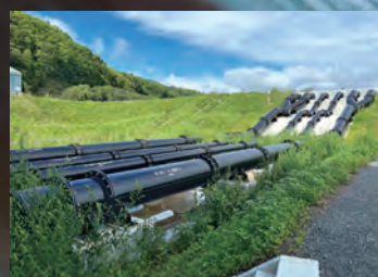
プラント配管
